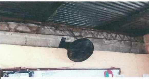
Foto 5: Se necesita mejorar el repello de la pared, se colocará cielo falso para evitar altas temperaturas durante el verano.
