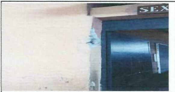
Foto 4: Se hará un mejoramiento de paredes donde están las puertas para mayor seguridad de las aulas.
