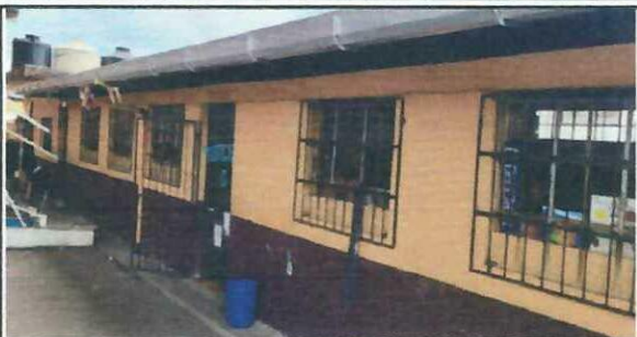
Foto1: Se debe hacer el mejoramiento de las paredes de las aulas debido a que la baja altura provoca alta temperatura en verano.
